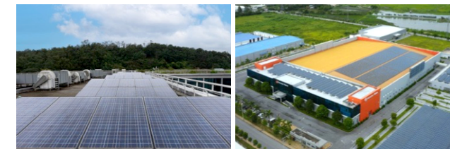
판교 사업장 태양광 패널
